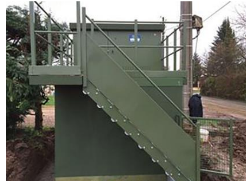
Figure 32 : Exemple de poste de transformation et de livraison HTA/BT réhaussé (rehausse pssa, s.d.)
